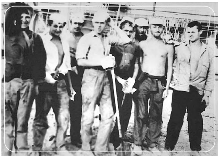
ССО «Тудей-71». Бригада В. Орешко на строительстве компрессорной станции газопровода Средняя Азия-Центр. Каракалпакия
