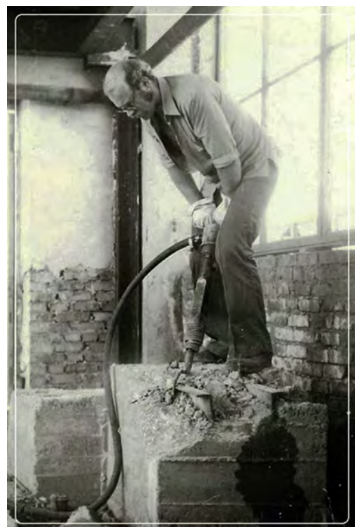
В прошлом году фундамент котельной заливали, а через год - его же разбивали, что и засвидетельствовано на снимке.
