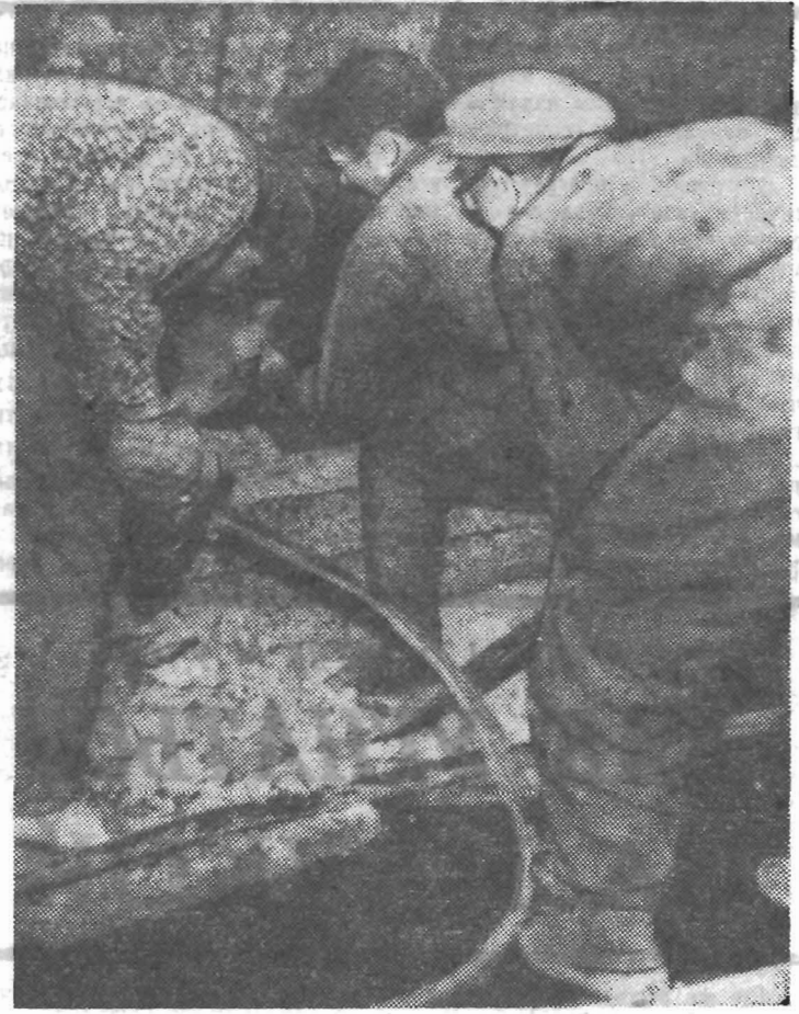
Что это — проходка тоннеля метрополитена? Нет, это в институтском общежитии ведется строительство спортивного зала. Строят сами студенты, своими руками. Значит, за качество работ беспокоиться не приходится!
