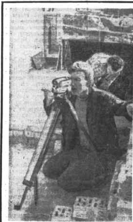
ИЗ ФОТОТЕЛОПИСИ ССО-72. БРИГАДИР ОТРЯДА «НЕПОДАЮЩИЕСЯ» ЕВГЕНИЙ РОГОЗЕНКОВ НА СТРОИТЕЛЬСТВЕ ШЕСТНАДЦАТИЧЛЕНА ТИРНОГО ЖИЛОГО ДОМА В ПОСЕЛКЕ БОЛЬШОЕ ЖАБИНО.
