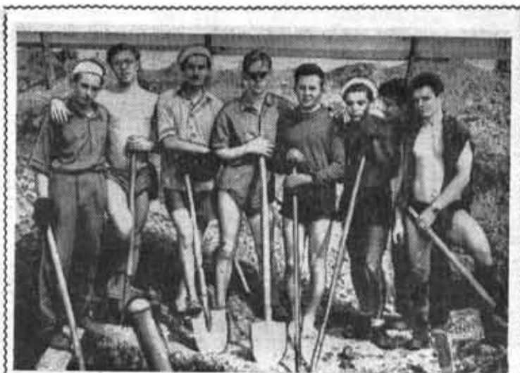
Этот эпизод сделан в совхозе «Федоровский» Гатчинского района. Бригада А. Вахмиштова, работающая на площадке фундамента, не раз проявляла исключительное упорство и трудолюбие. Служителям-строителям приходилось порой работать в очень трудных условиях, по колено в воде. Но все же задания, как правило, выполнялись в срок. Фото Х. Кремера
