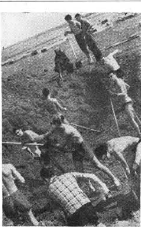
Земляные работы. Скоро на месте этой огромной ямы вырастет построенный литмонавтами отличный свинарник.
