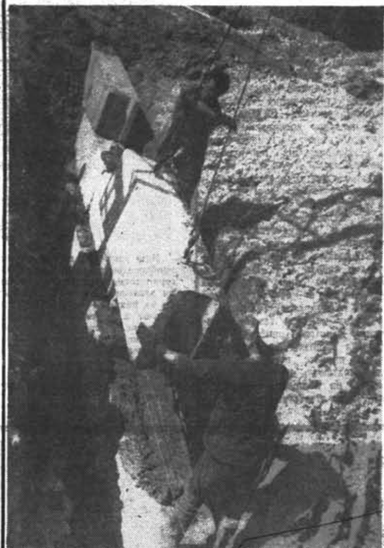
В студенческих строительных отрядах комсомолы получают отличную закалку. Ветераны ССО передают здесь свой немалый опыт новичкам. На снимке: участник пяти трудовых семестров Николай Савельев и второкурник Юрий Широков на закладке фундамента шестнадцатиквартирного дома (ССО «Неподдающиеся»). Фото студента Юрия Гатчина.
